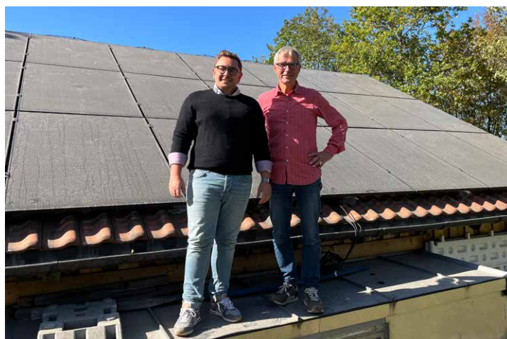
Richard Michl und Florian Zarbo (links) am Pumpenhaus des Hochbehälters mit der neuen PV-Anlage.
